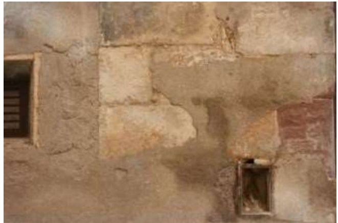
Fig. 3. Morters afegits antics als baixos de l'edifici
