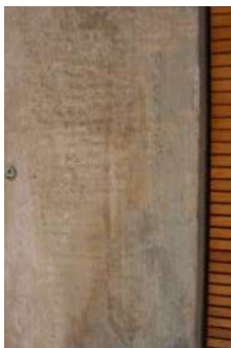
Fig. 8. Revestiment erosionat per fricció de les persianes
