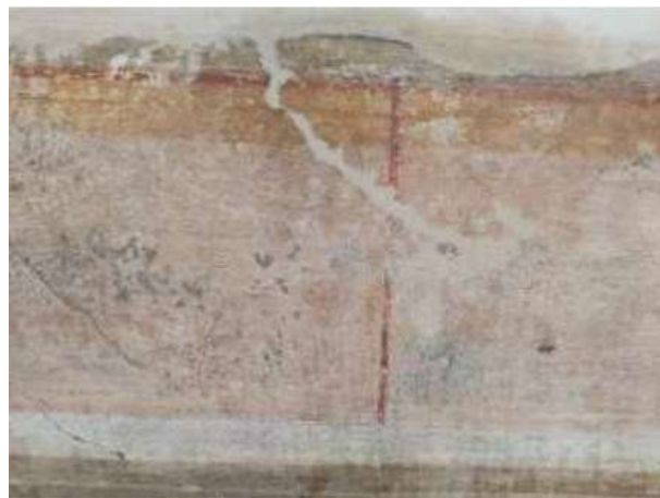
Fig.54. Fissura i pèrdua després de reintegració matèrica
