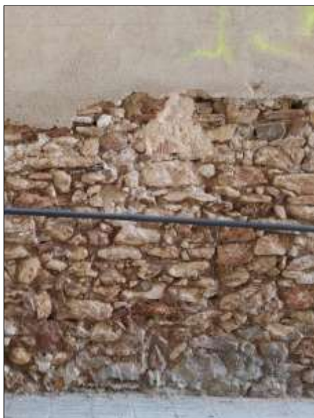
Reparacions en la maçoneria i pèrdua de morter de junta
