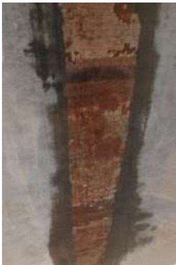
Fig.22.. Cala efectuada entre les dues portes de la planta baixa.
