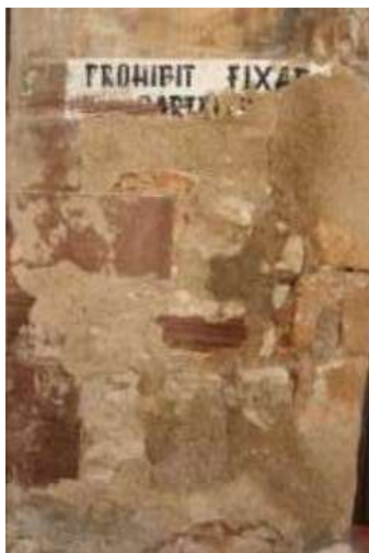
Fig. 6. La maçoneria queda vista per la pèrdua del revestiment
