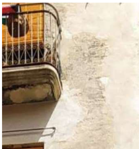
Fig.9. Zona erosionada a la part alta de la façana
