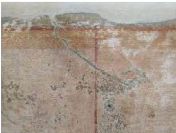
Fig.53. Fissura i pèrdua abans de reintegració matèrica
