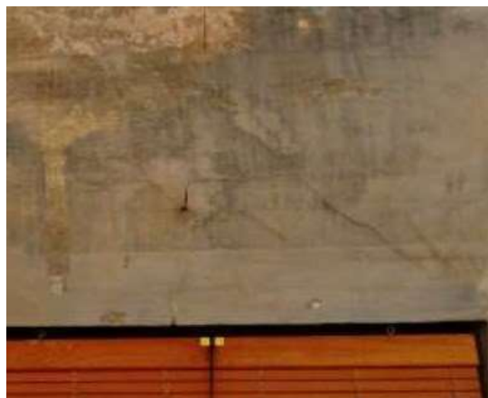
Fig.11. Fissures sense bossa a les llindes del primer pis provocades per moviments d'assentament de l'edifici.
