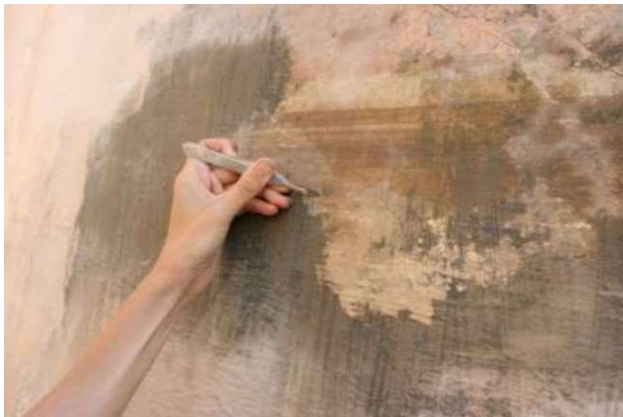
Fig.25. Primera cala efectuada sobre la llinda de l'obertura del primer en un estat més avançat. Es comencen a identificar les formes d'una cornisa.
