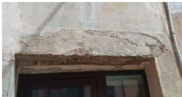
Fig. 7. Pèrdua del revestiment de la llinda de la porta dreta
