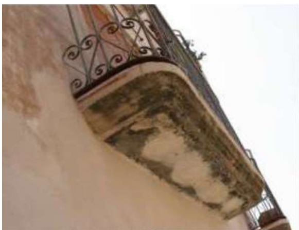
Fig. 13. Sota balcó amb morters afegits en mal estat i no integrats
