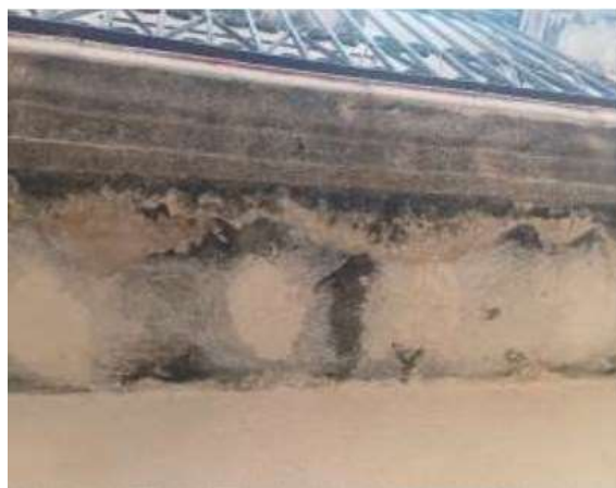
Fig.14. Sota balcó amb morters afegits en mal estat i no integrats
