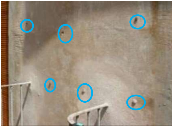
Fig. 2. Elements de subjecció obsolets
