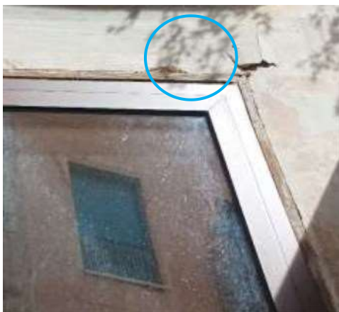
Fig.10. Bossa d'aire amb fissura
