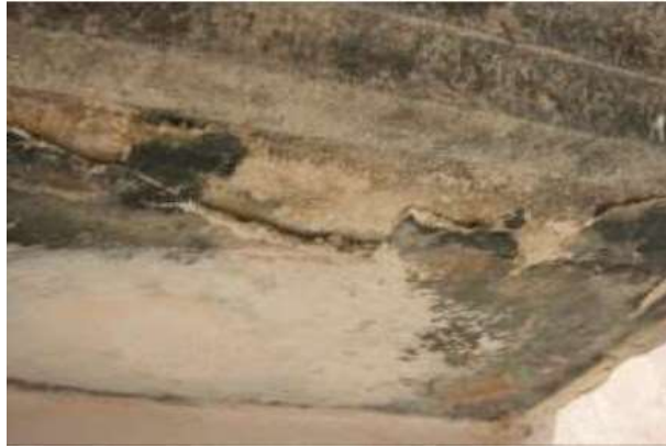
Fig.16 .Plaques en perill de despreniment
