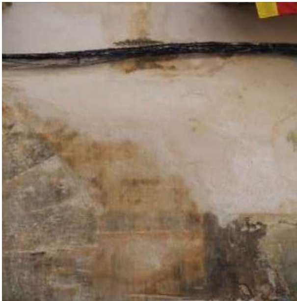
Fig. 4. Morters de reparació aplicats l'any 2.023 a la part superior dels baixos per cobrir una zona on s'havia perdut el revestiment.
