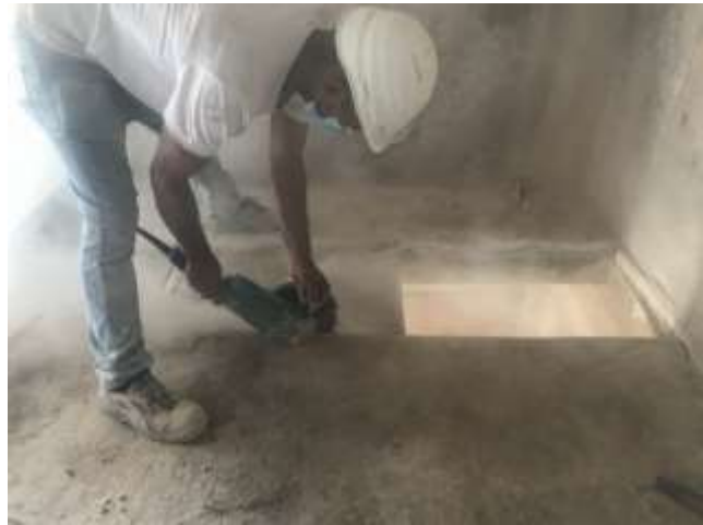
Fig. 14. Execució de talls longitudinals coincidint amb la part central de la biga.
