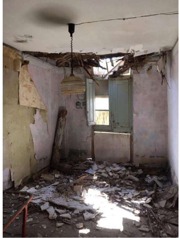
f26. Vista interior de la coberta, els problemes estructurals degut a l'entrada d'aigua són evidents.
