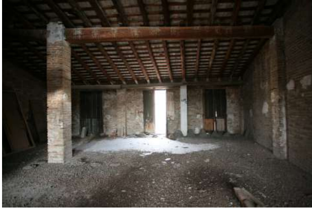
f21. Vista interior del sota-coberta amb la brutícia i amb les fusteries deteriorades.
