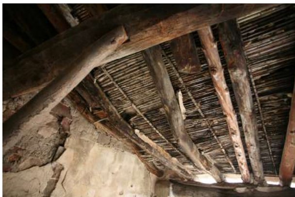
F17. Vista interior de la coberta orientada al pati d'illa, a destacar els problemes de degradació de l'estructura i els materials usats.
