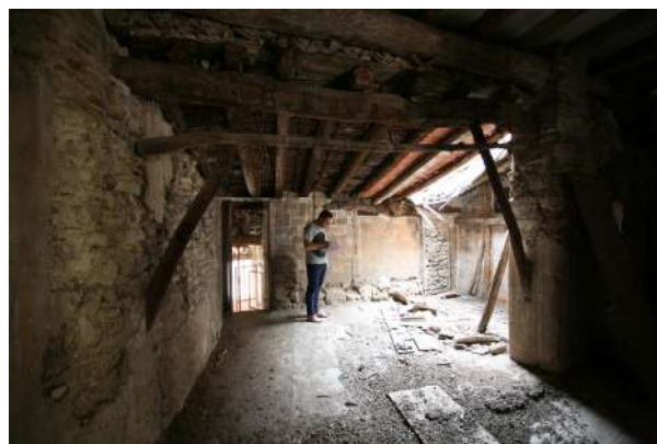
F18. Ubicació de la filtració d'aigua a l'immoble. El pas de l'aigua està engrandint aquest orifici debilitant tota la coberta i degradant tot allò afectat a les plantes inferiors.
