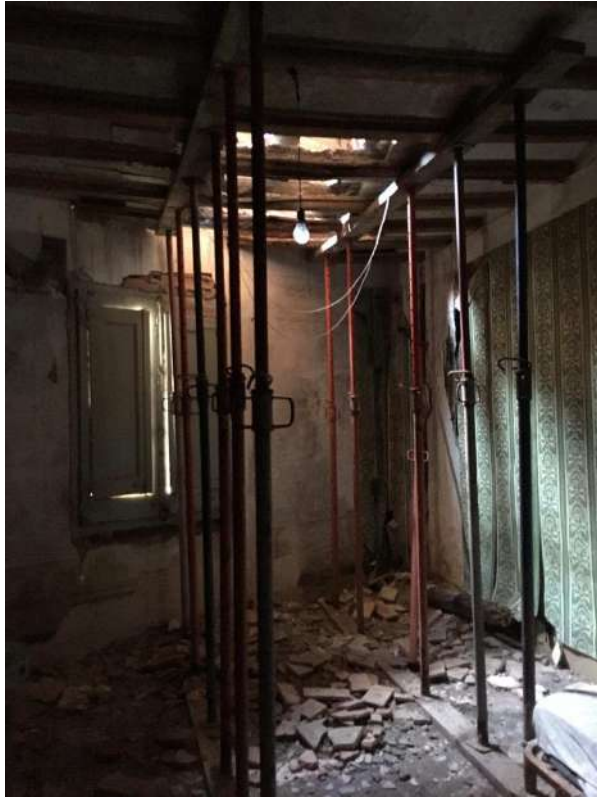
f25. Vista interior de l'immoble a la primera planta, s'aprecia l'estat de deteriorament dels sostres.
